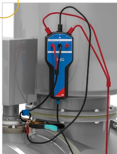
Катушка Роговского, установленная в КРУЭ
